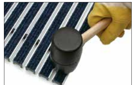
3. Neue Ripsstreifen mit Selbstklebeband in das Aluprofil einkleben und ggf. mit einem Gummihammer den Klebeprozess verstärken.
